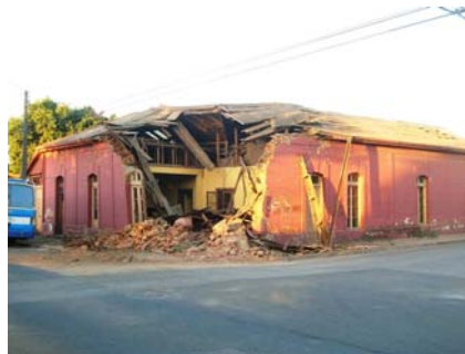
Caída de dos muros (G5) en Parral.
