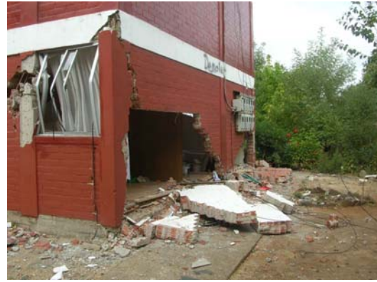
Caída de parte de un muro y grieta en zona crítica del pilar (G5) en un edificio de 3 pisos en Cauquenes.
