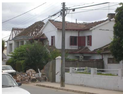
Agrietamiento típano (G2) en Cauquenes
