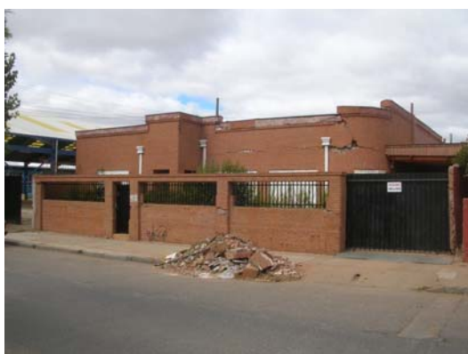
Agrietamiento antetecho (G2) en Cauquenes
