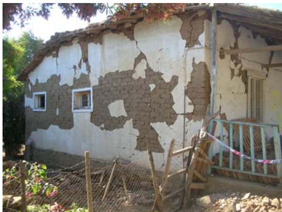
Desprendimiento de estuco (G2) en Lolol.
