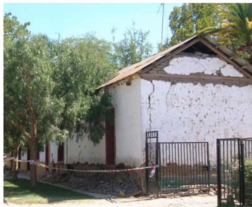
Grietas verticales en encuentro de muros (G2) en Peralillo.
