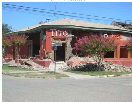
Colapso de más de un muro (G5) en Peralillo
