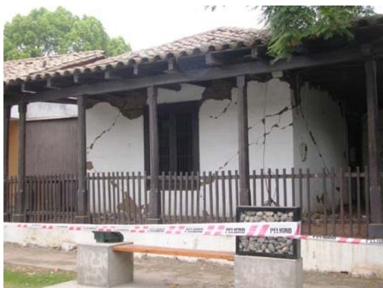
Grietas diagonales en muro (G3) en Pichidegua.
