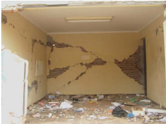
Grietas diagonales en muro (G3) en Cauquenes
